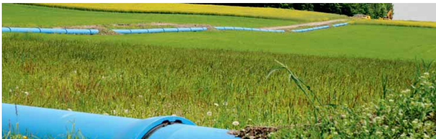
Mobilní potrubí: Hartenstein DN 600
